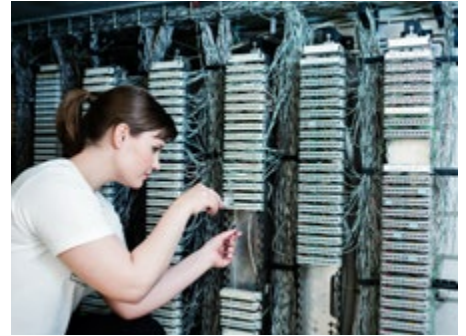
Damit die Anschlüsse stimmen: Zuordnung von Leitungen in einer Telefonverteilung
