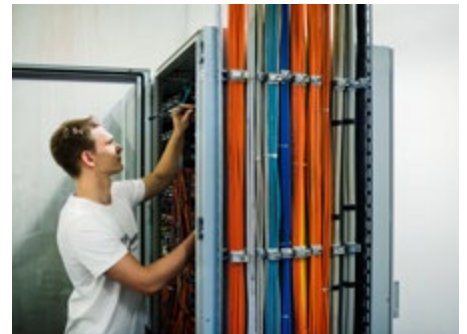
Auch auf der Langstrecke muss die Verbindung stehen: Prüfen von gebäudeübergreifenden Leitungen
