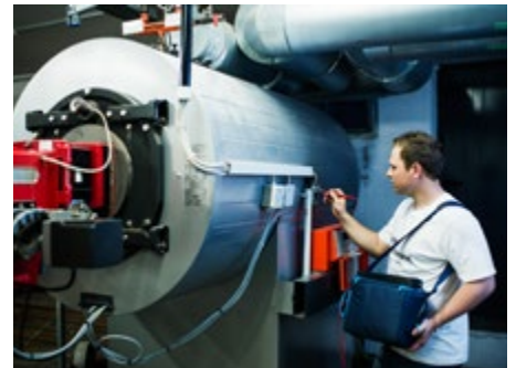
Alles normgerecht? Prüfen der Schutzmaßnahmen an Anlagenteilen und Messung nach DIN VDE 0100-600
