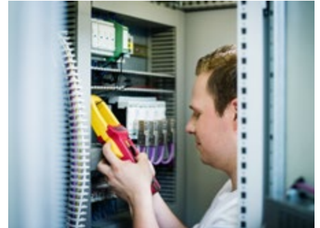
Damit der Strom sicher fließt: Überprüfung der Lastkreise eines Stromkreises mit Hilfe eines Zangenamperemeters
